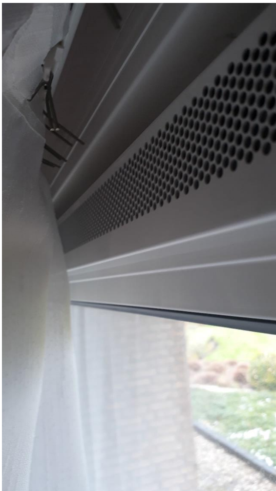
Foto 17 Aanwezige ventilatievoorziening voorgevel slaapkamer
