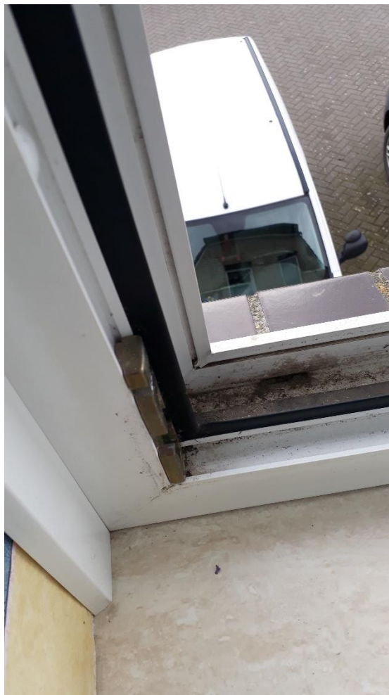
Foto 6 Kunststof kozijnen en kierdichting, zijgevel slaapkamer groot
