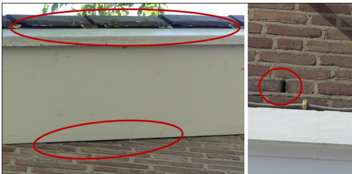
Figuur 3.2 De kantpannen van de bebouwing kieren dermate dat vleermuizen toegang hebben tot de dakruimte. Ook tussen de gevel en de overstek zijn kieren aanwezig. Aan diverse zijden van het voormalige restaurant zijn open stootvoegen aanwezig. Door de aanwezige invliegopeningen is het voor vleermuizen mogelijk om in het pand van het voormalige restaurant een geschikte verblijfplaats te vinden.
