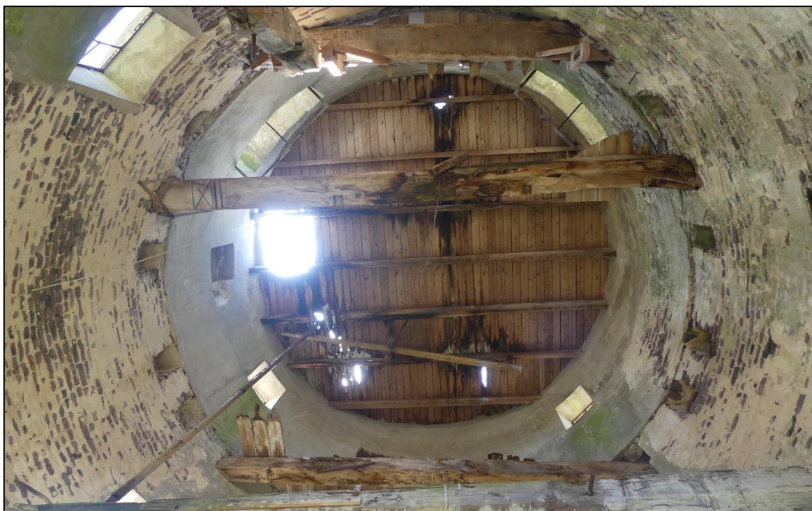
Figuur 3.1 De oude molenromp is niet geschikt als verblijfplaats voor de steenmarter. In het dak van de romp zitten meerdere gaten waardoor regen naar binnen komt. Eveneens zitten er gaten in de muren waardoor het tocht. Hierdoor zijn in de romp geen geschikte wegkruipplekken aanwezig voor grotere zoogdieren, zoals de steenmarter.
